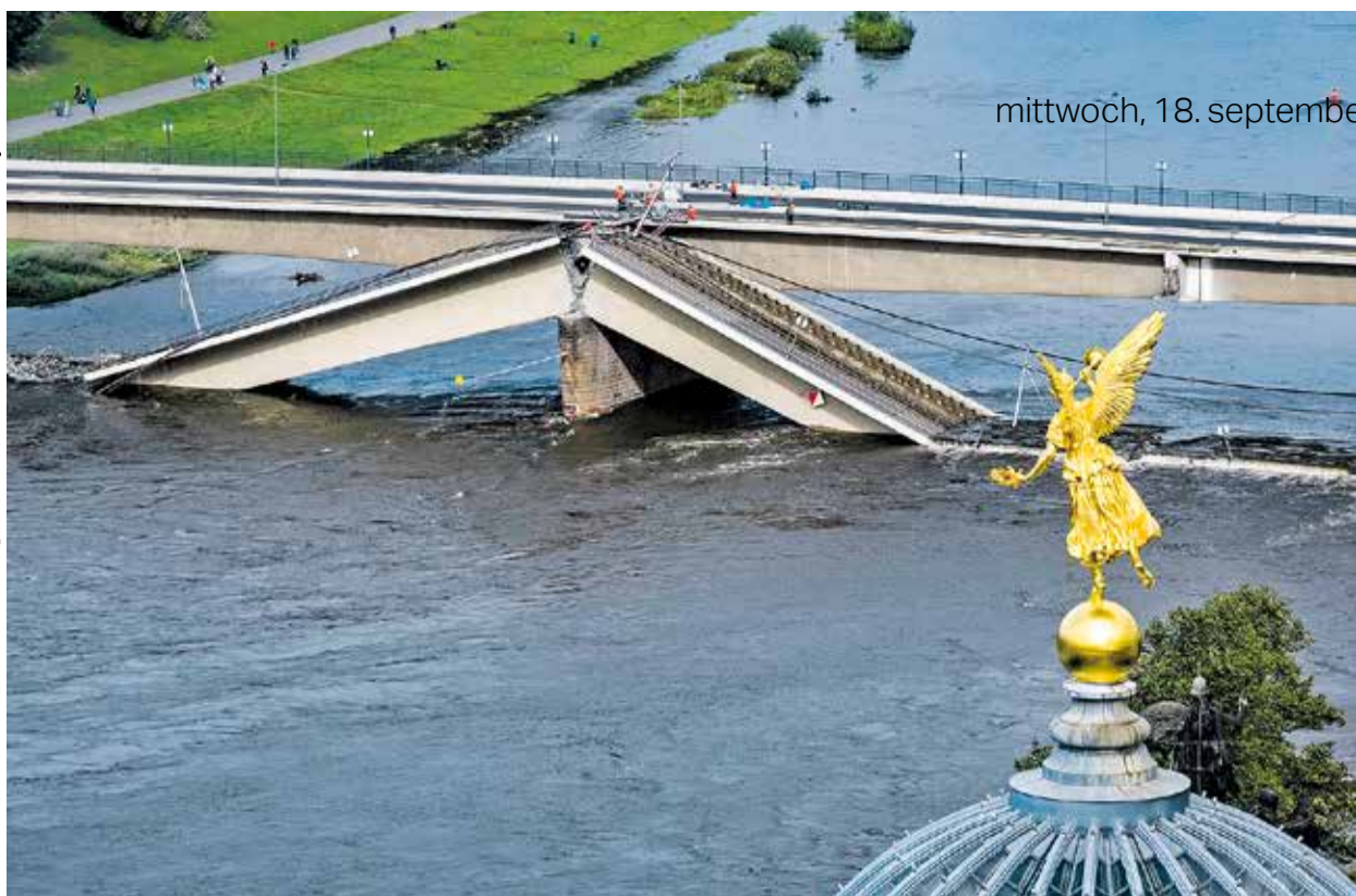
Eingestürzt unterm Blick des Engels: die Carolabrücke in Dresden, im Vordergrund die Kuppel der Akademie der Künste Foto: Frank Biene-wald/imag
