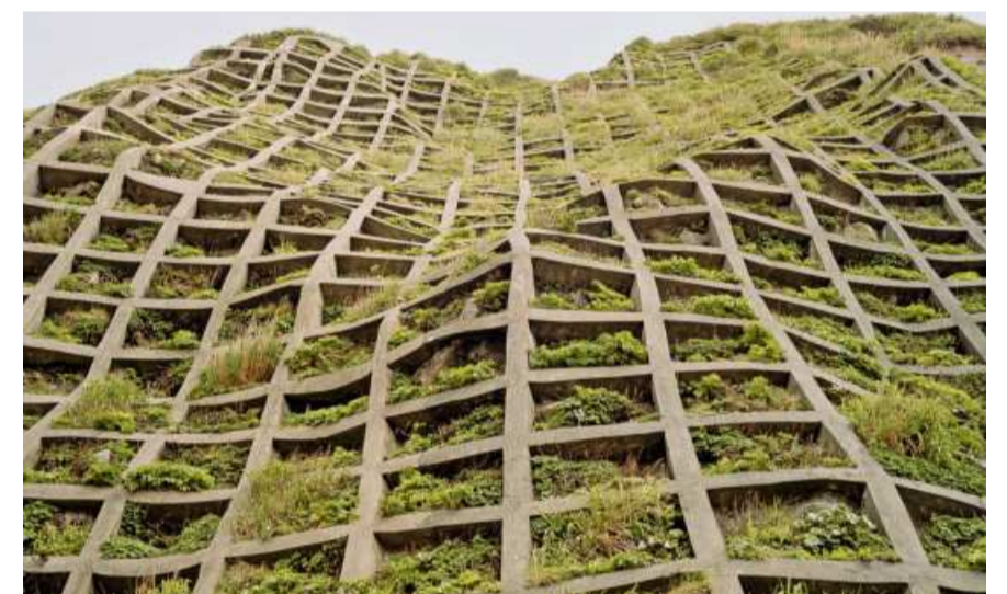
Gebaute Natur: Ein mit Beton verstärkter Hang auf der japanischen Insel Aogashima Foto Yasushi Okano
