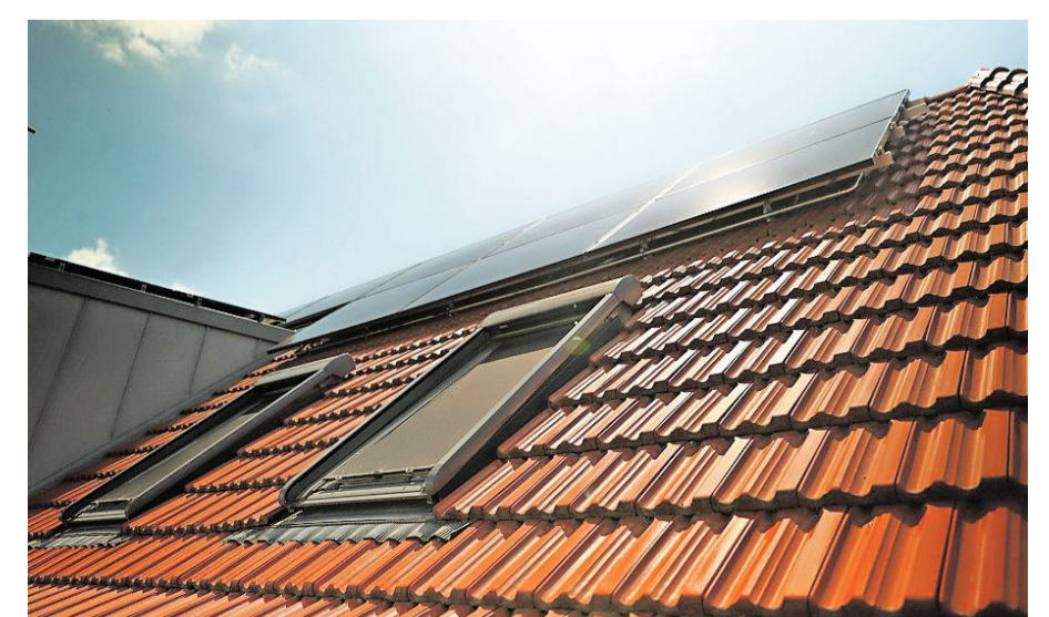
Strom und Wärme zugleich: Anlage des PVT-Herstellers Sunmaxx auf einem Berliner Mehrfamilienhaus. FOTO: SUNMAXX
