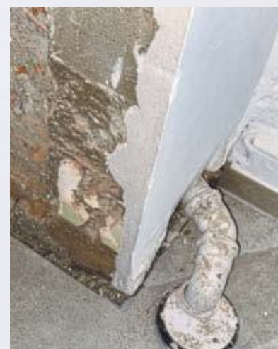
Bruggers Ehemann Thomas Spitzer hat den Baupfusch dokumentiert
