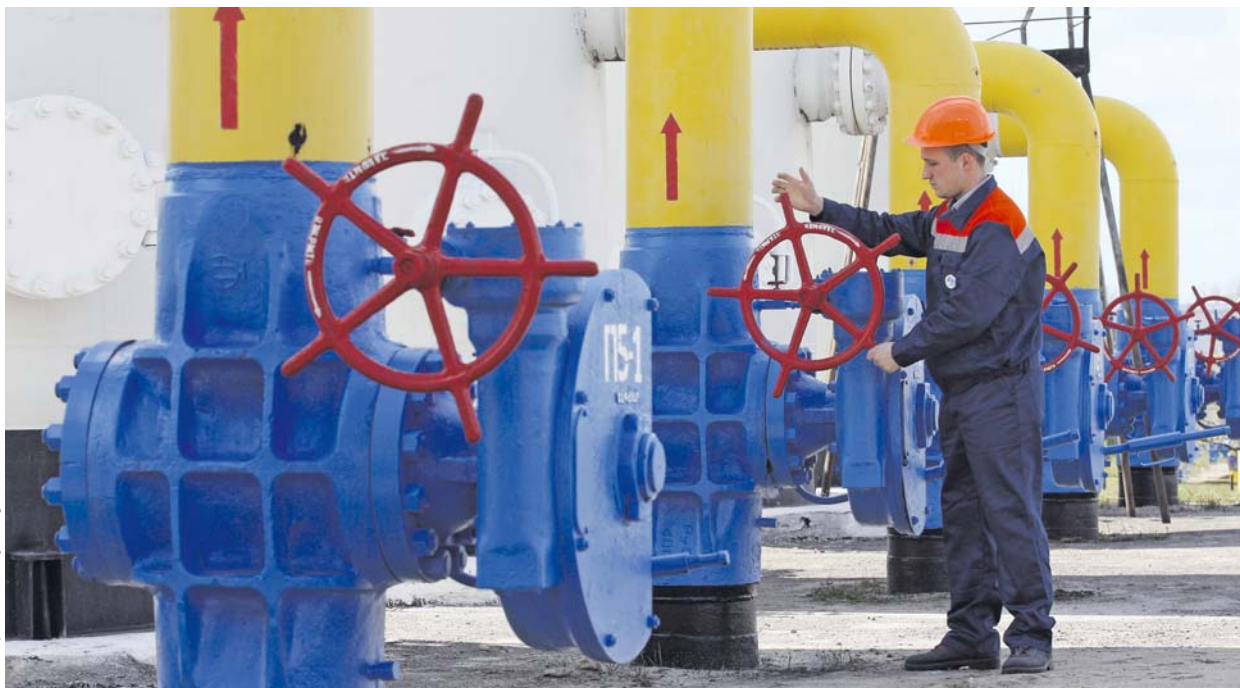
Verdichterstation einer Gaspipeline in der Ukraine: Noch immer fließt Gas aus Russland nach Europa.
