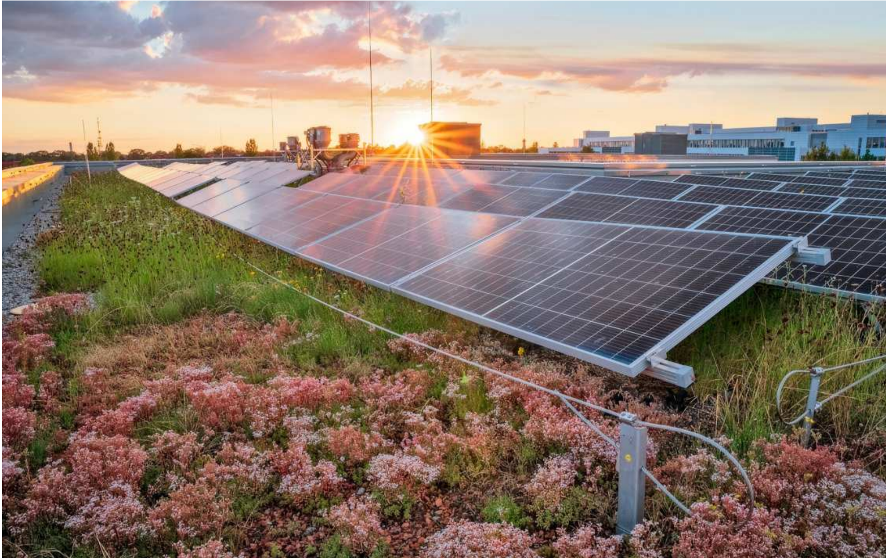
Klimatechnik im Doppelpack: Ein begrüntes Energiedach kühlt und liefert sauberen Strom. Foto Optigrün international AG
