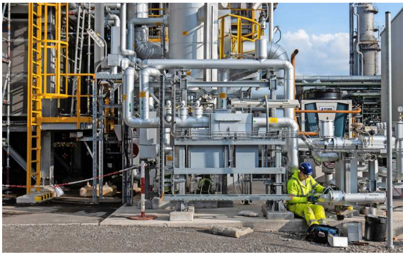
Elektrisch beheizter Steamcracker-Ofen auf dem Gelände von BASF
