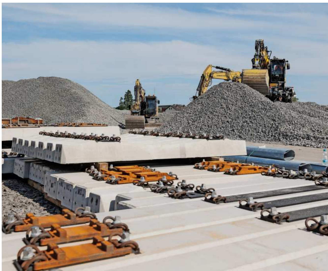
Alles ist bereit: Bagger, Schotter und Schwellen für die Erneuerung der Bahnstrecke
